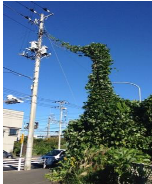
図 1. 配電設備（配電柱や柱上変圧器）への蔓植物の接近例 支障となる植物の発生源を対処しなければ毎年除草が必要となります。
